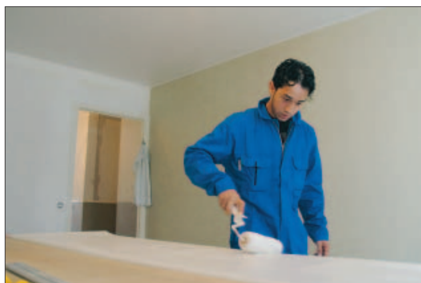
Tre dagar i veckan gör Orhan Ajrizi praktik. Då renoverar han lägenheter på flyktingförläggningen. Det hjälper honom att hålla tankarna borta för en stund.
